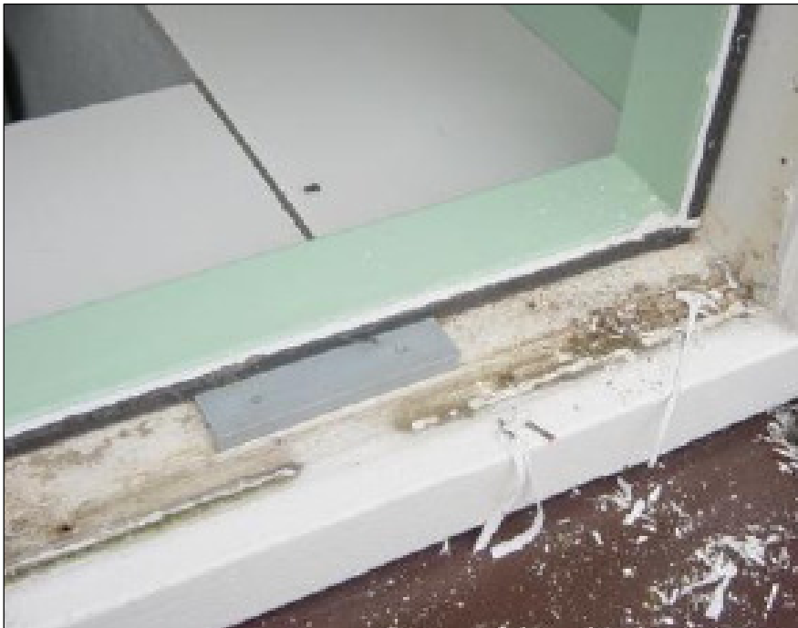
Vervuiling onder de liggende glaslat.
